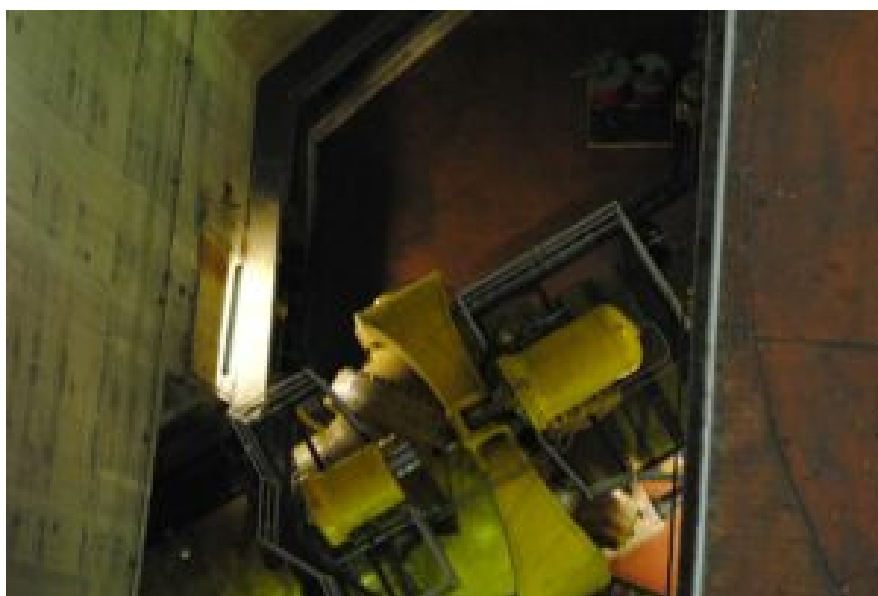
la valvola posta a monte della turbina e che intercetta l'acqua della condotta
